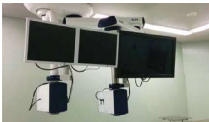
天吊りモニター
